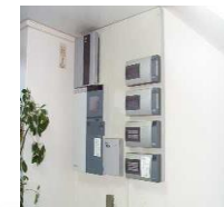
SECOMシステム 24時間 セキュリティ管理 各種センサー(108箇所以上)
